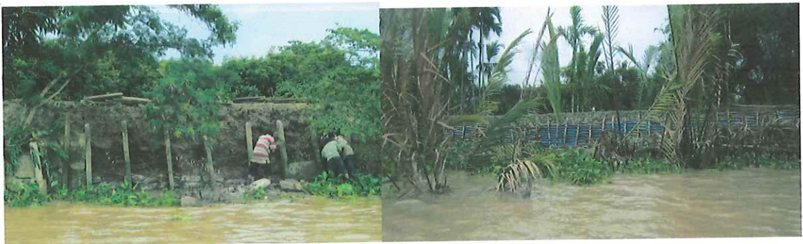
Hình 2.4 Hình ảnh Hiện trạng xói lở bờ sông khu vực kè
