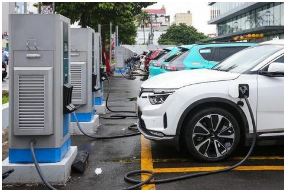
Hình 1.12. Trạm sạc xe ô tô điện
