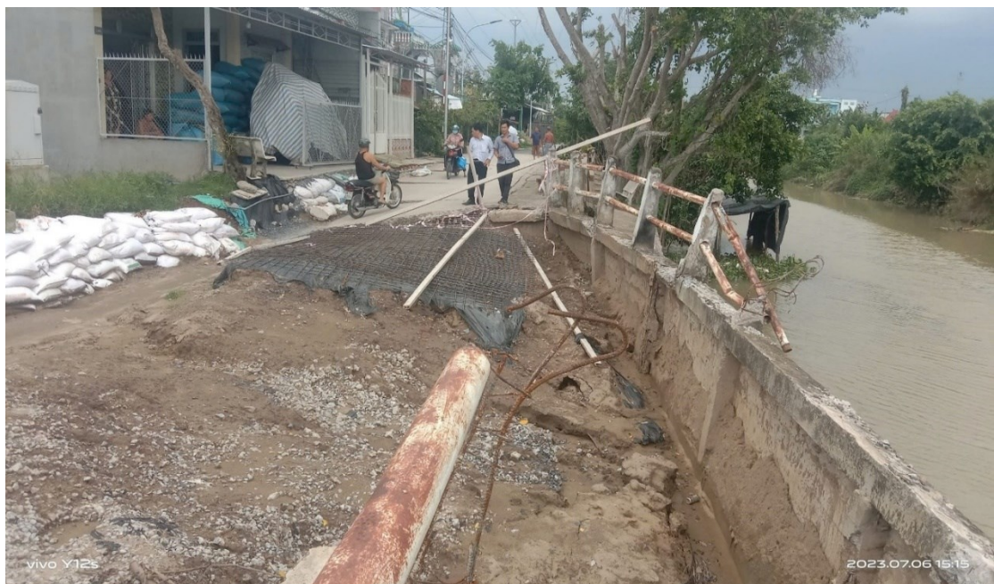
Hình 1.5 Sạt lở đường bộ.
