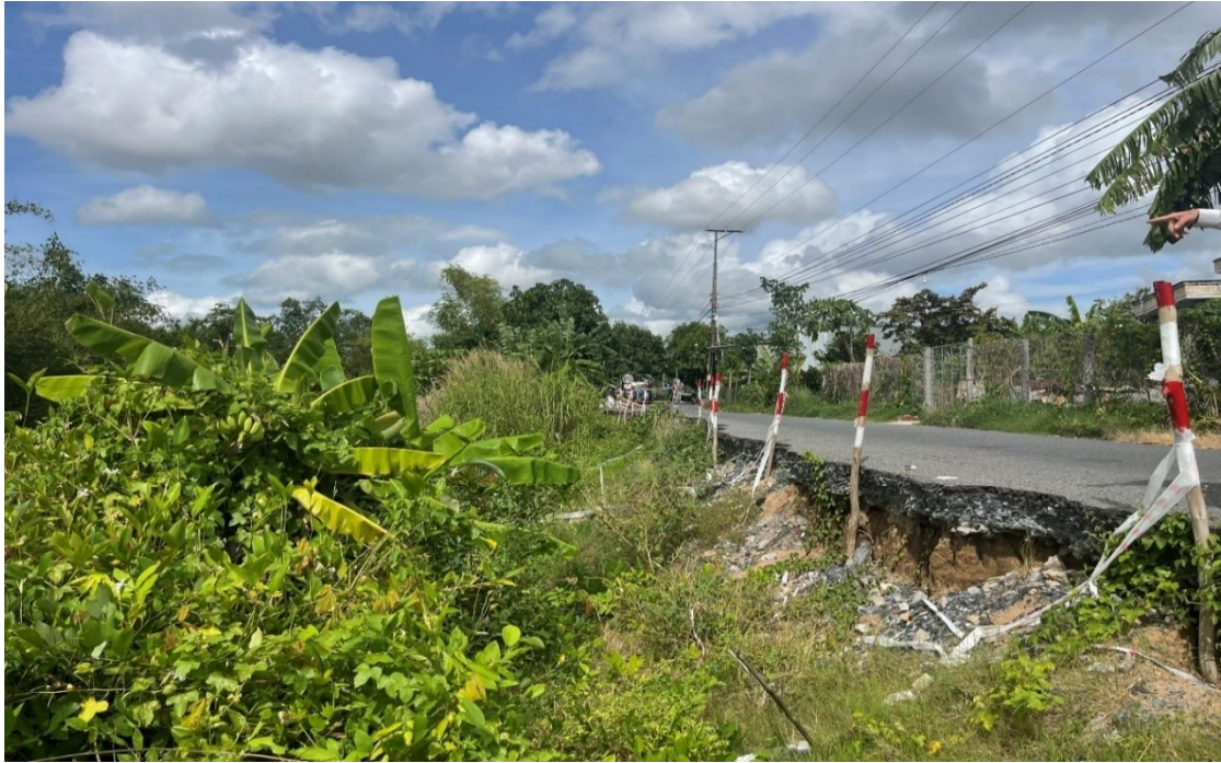
Hình 1.6. Sạt lở đường bộ.
