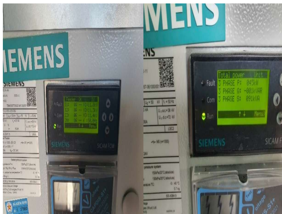
Hình 3. 20. Hình ảnh hiển thị P, Q, S trên FCM khi trạm biến áp hoạt động
